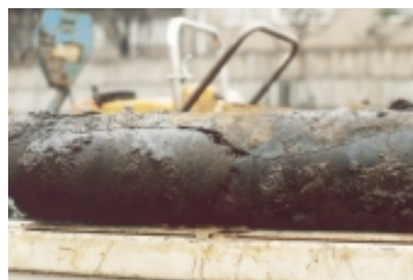
震災により破損した水道管
